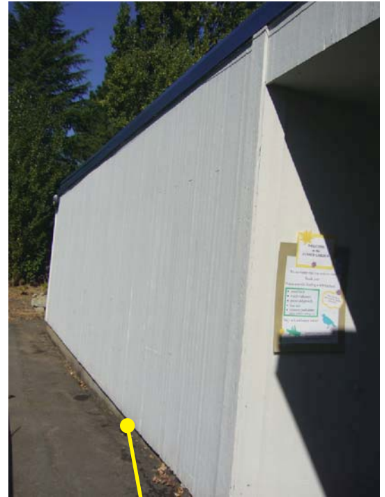
P1010381.JPG Dryrot along bottom edge of siding. (Building 'E')
