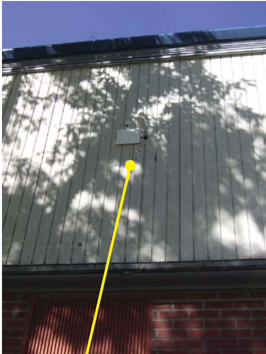
P1010389.JPG Bird damage.
